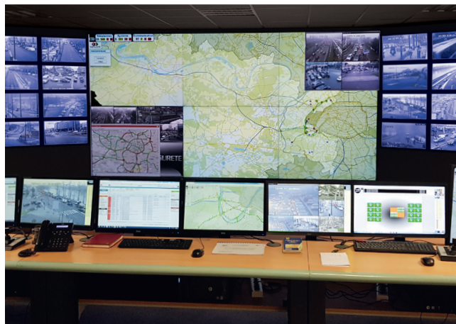
Poste Central SITER Département des Hauts-de-Seine
